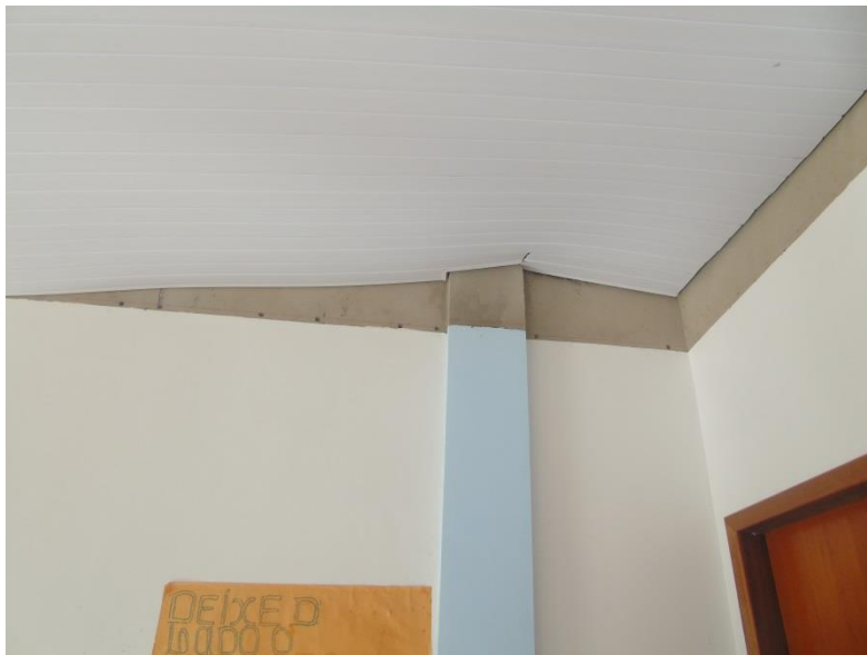
Figura 11: forro do teto da escola fora do lugar
